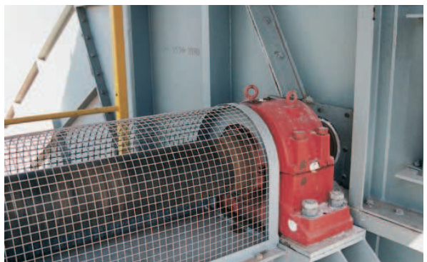
Unidad motriz de un ventilador
