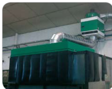
ASPIRACIÓN CELDA ROBÓTICA
