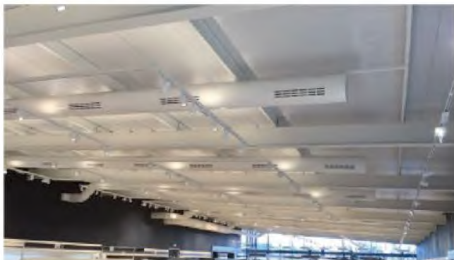
LAU Tube y conducto con pintura blanca RAL 9003.
